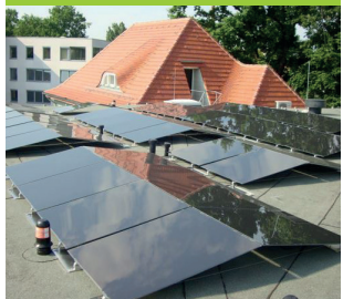
Eine unserer drei PV-Anlagen.
